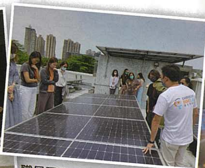
職員認識院內的太陽能板系統
